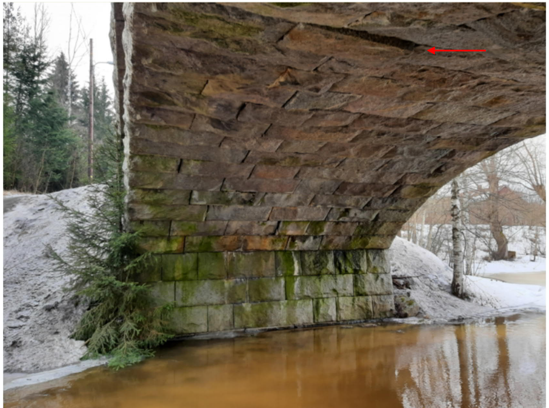
Kuva 6. Holvin kivissä siirtymää, kuvassa suurin siirtymä osoitettu nuolella. Kuva otettu tuen 2 oikealta reunalta.
