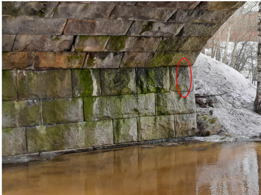
Kuva 4. Tuella 1 kantamuurissa yksittäinen hajjennut kivi (holvin kantakivi).
