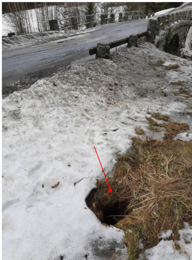
Kuva 16. Sillan eteläpuolella tiepenkereessä reikä.
