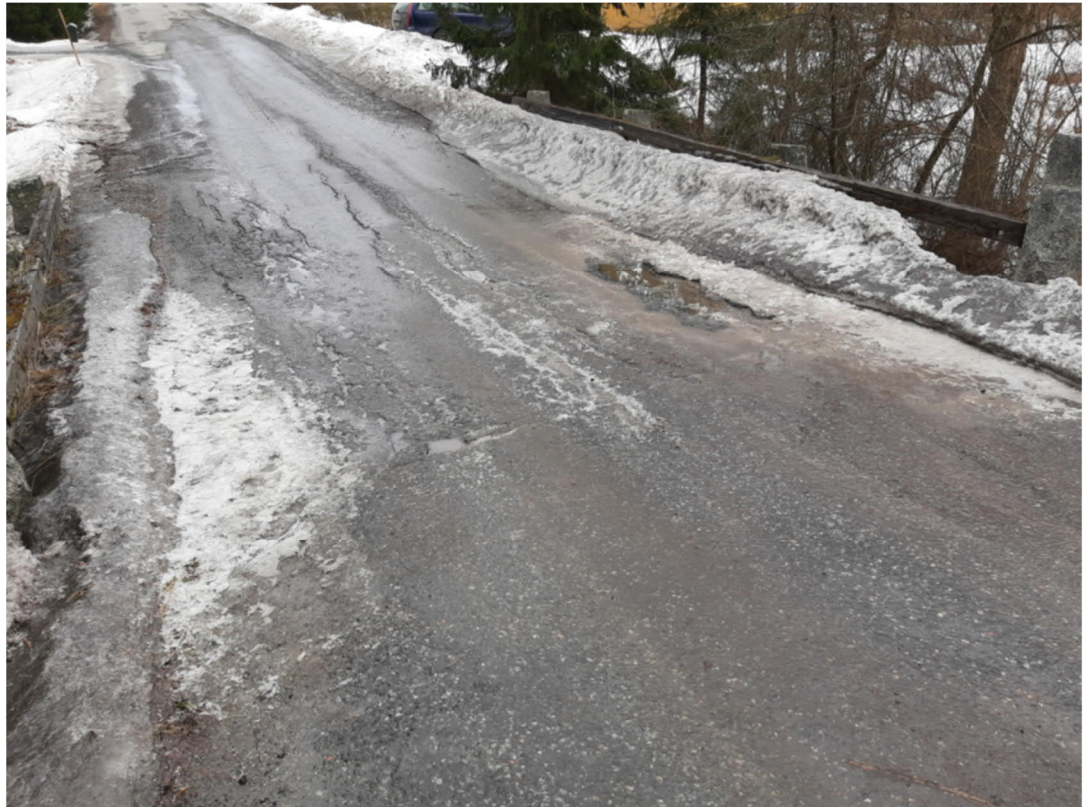
Kuva 15. Päällysteen pituussuuntaista halkeilua ja purkaumia, merkittävät painumat ja päällysteen purkaumat heti sillan maatumien jälkeen reunoilla tuen 1 päässä.
