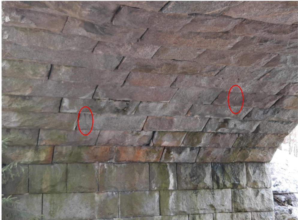
Kuva 7. Holvin kivissä oli yksittäisiä halkeamia, kuvassa ympyröity.
