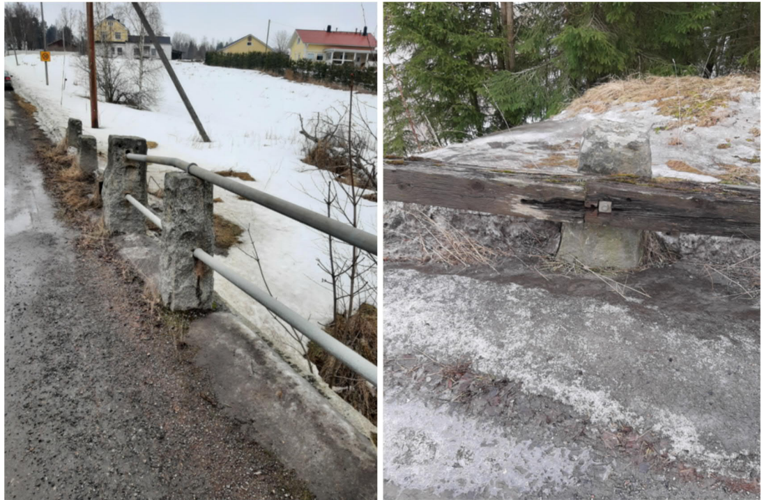
Kuva 13. Sillankaiteen johteet olivat irronneet kaiteiden päissä. Tiekaide puuttuu tuen 2 päästä oikealta. Kuva 14. Tiekaiteiden puisissa johteissa on vakavia lahovaurioita ja ne ovat matalat.
