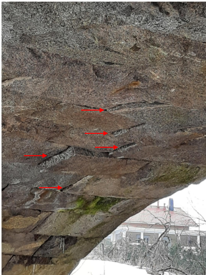
Kuva 8. Kuvassa holvin suurin siirtymä ja sen viereiset siirtymät osoitettu nuolella. Kuva otettu tuen 1 vasemmalta reunalta.
