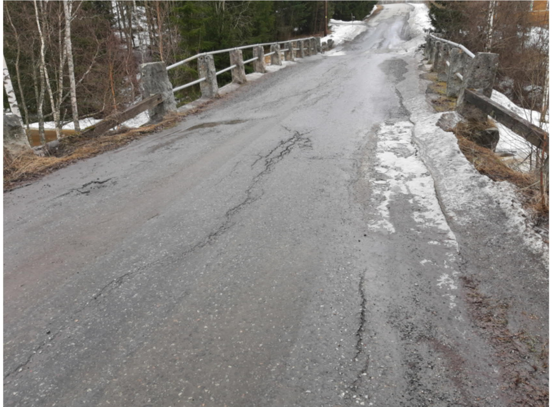
Kuva 12. Päällysteen pituussuuntaista halkeilua ja purkauksia sekä sillan osalla että tiellä siltapaikalle, kuvattu tuen 2 suunnasta.
