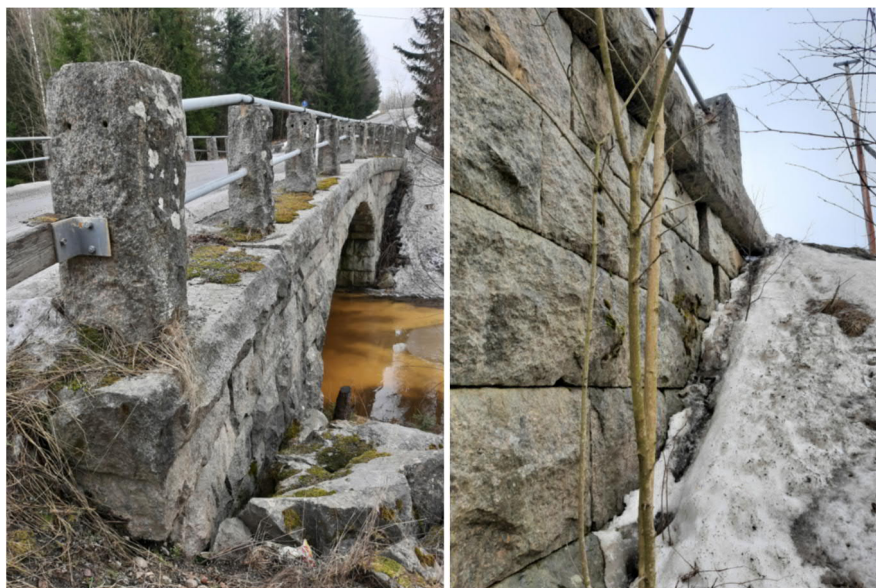
Kuva 2. Siipimuurit ovat auenneet, kuva sillan vasemmasta reunasta.
