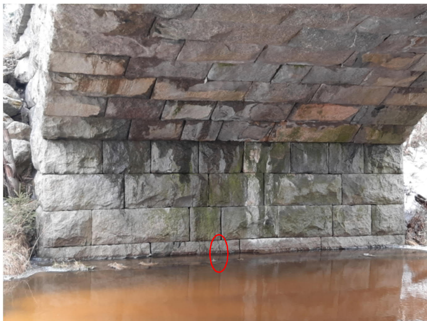
Kuva 5. Tuella 2 kantamuurissa yksittäinen hajjennut kivi.
